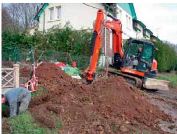
• Pose de fosses micro-station par le propriétaire – Janvier 2019 Quartier de la Galoperie
